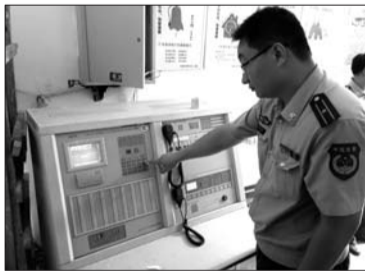
消防人员正在检查消防自动设备。
