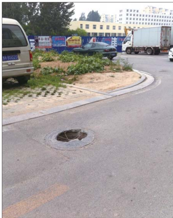
天华领秀城北门西侧破损井盖。见习记者 杨双媛 摄
