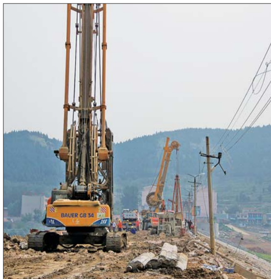
狼猫山水库内的库水已经被放干，正在大修，大坝上正在进行施工。照片均为本报记者 蒋龙龙 摄
