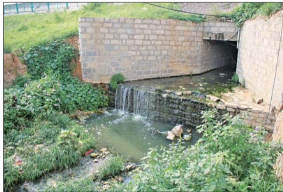
卧虎山水库的污水口仍然在向水库里排放污水。
