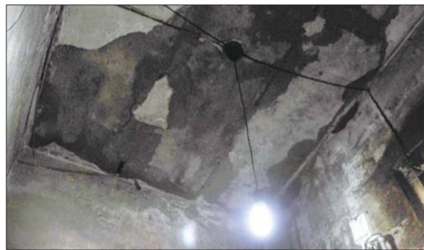
由于长期被雨水渗漏、侵蚀,很多楼房出现漏雨。 本报记者 王媛 摄
