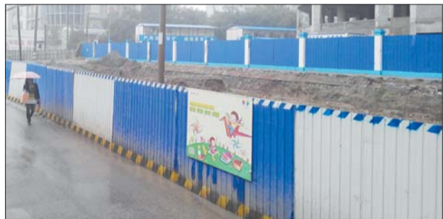
纬十二路路面围挡内仍有未进行的路面施工。本报记者 王皇 摄
