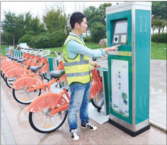
工作人员对设备进行调试。本报记者 公素云 摄
