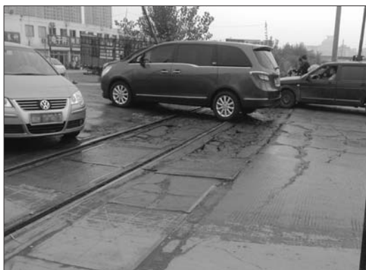
商贸大道与铁路交汇处道路坑洼。 本报记者 徐良 摄
