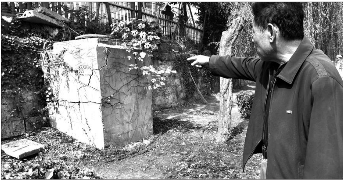
▶河边污水管道老化破损,溢出的污水直接流入了河道。本报记者 公素云 摄
