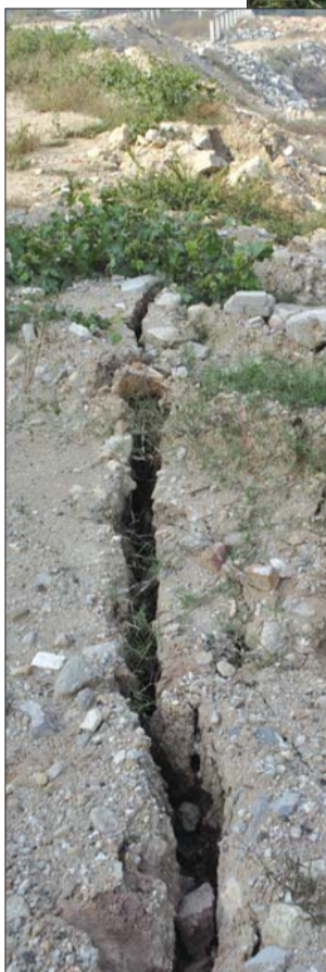
堆积在河道内的建筑垃圾不断开裂坍塌。
