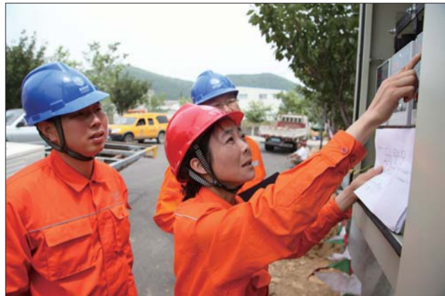
▲文艳正在南曲阜村指导作业人员对新增容变压器安装线路进行现场核对。 通讯员 刘中华 摄
