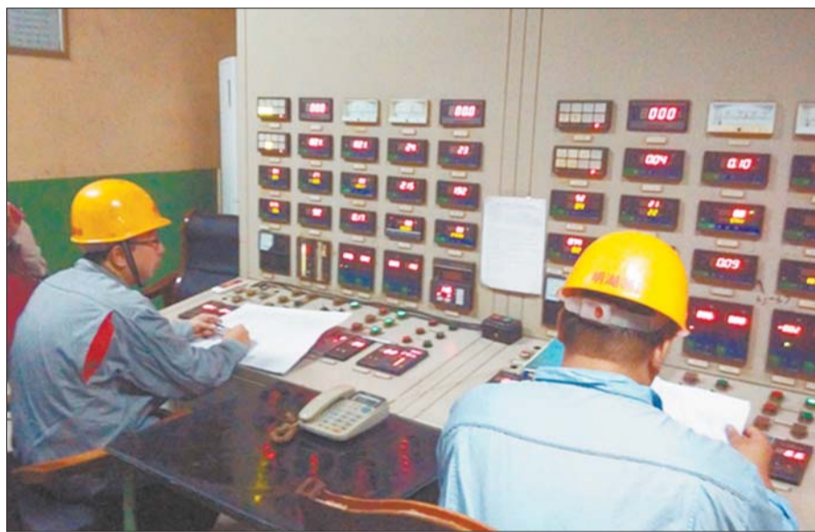
在明湖热电厂,工作人员通过仪表区实时监控锅炉数据。
