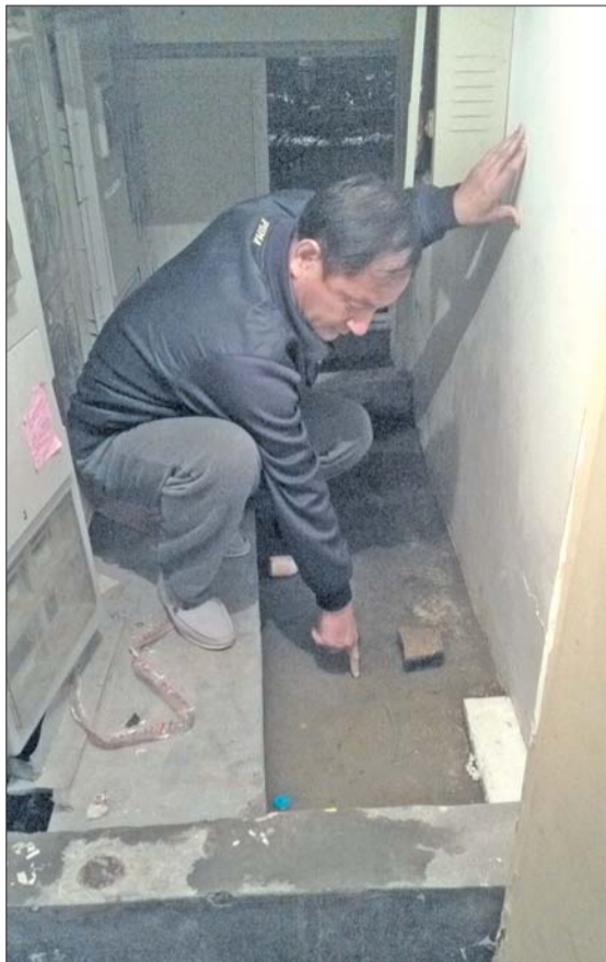
因为管道漏水把居民的地下室给淹了。本报记者 蒋龙龙 摄
