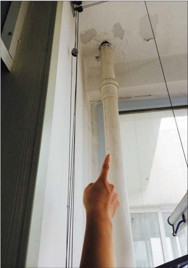
徐女士家被雨渗过的屋顶墙皮脱落。 本报见习记者 杜雅楠 摄
