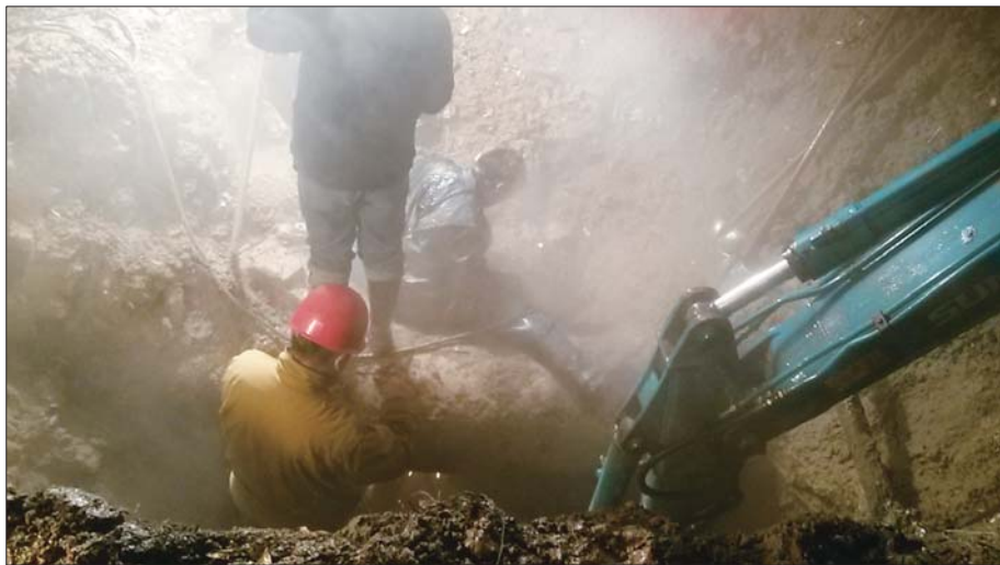
供热公司的工作人员下到泥坑中查找管道漏点。本报记者 张召旭 通讯员 苗跃 摄
