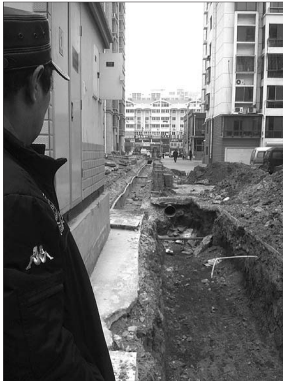
小区预留的管线裸露在外,迟迟没有暖管接入。 本报记者 张晶 摄
