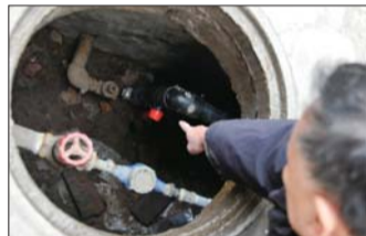
11月初供水管道改造,3号楼被排除在外。 本报记者 王鸿哲 摄
