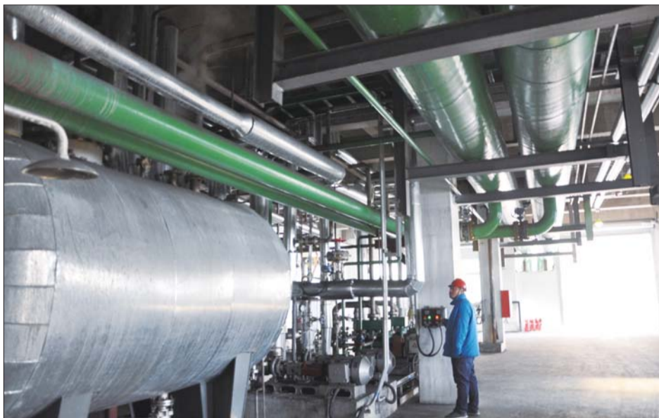
山东科宇能源有限公司生产车间内,工人正在利用自动化设备进行检测。
