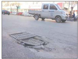
下河桥站台前井盖被轧坏露出钢筋。本报记者 赵兴超 摄
