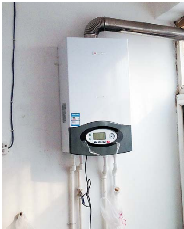
居民家中安装的壁挂炉(燃气)。 本报记者 张帅 摄
