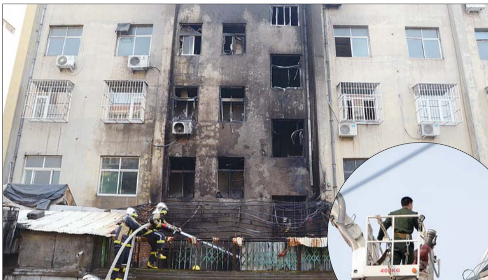
▲过火后的楼体一片漆黑。本报记者 王媛 摄
