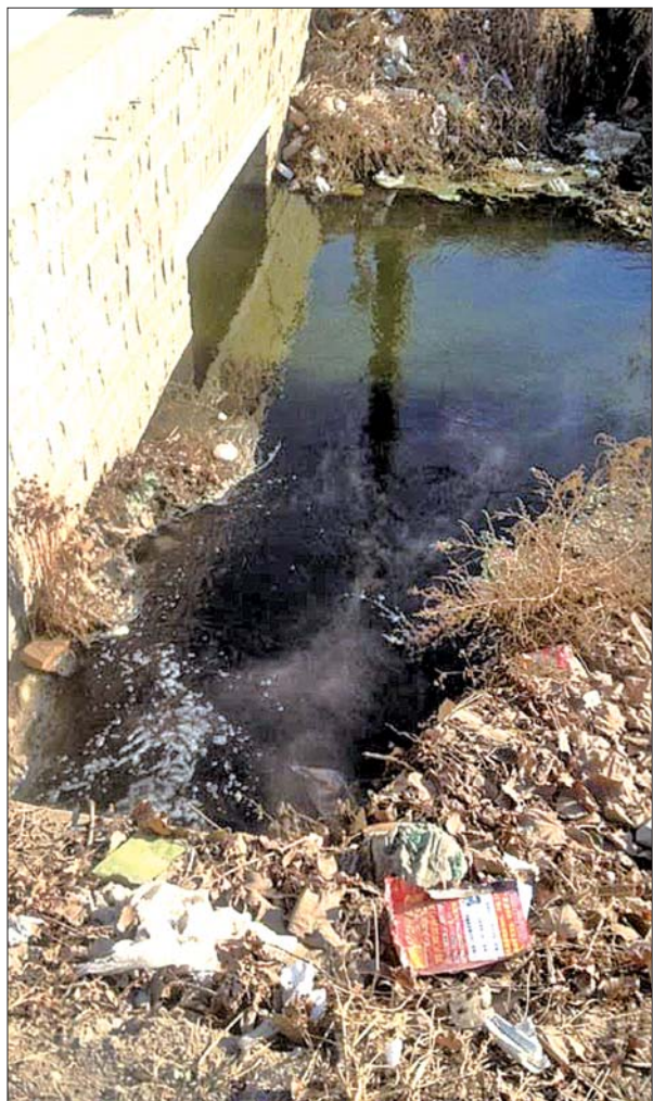
地下排水口正在排水。
