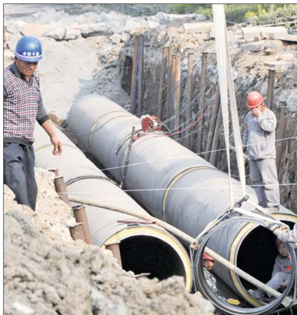
去年,城区实施了两大供热工程,图为昌润国电工程施工现场。(资料片) 本报记者 张召旭 摄
