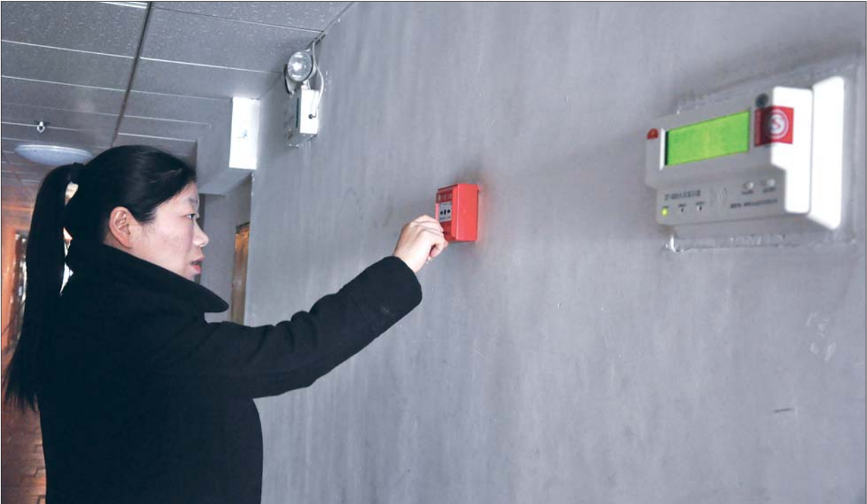
楼层走廊内都更换了新的消防报警器。本报记者 公素云 摄
