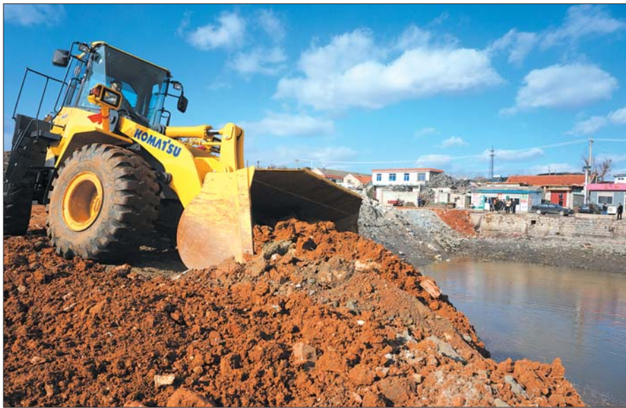
27日上午,在东口码头,施工队伍正在回填港湾。本报记者 李静 摄
