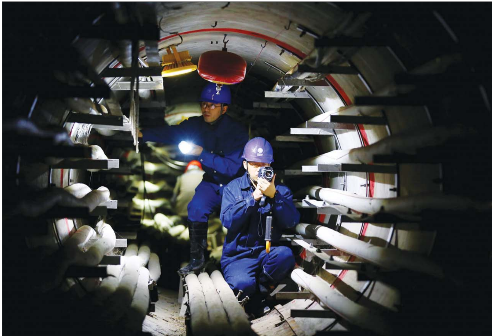
27日，国网淄博供电公司电缆运检班员工正在地下隧道，检测电缆温度和负荷。为了保障春节期间用电安全，该公司对地下电缆增加了一次巡视。本报记者跟随体验，高约两米的隧道，各种类型的电缆线叠放着，地面高低不平，行走300米用了40分钟，而每个巡线工一天要走5公里。 本报记者 王鸿哲 摄影报道
