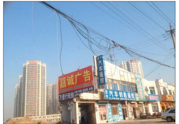
乱糟糟的线缆没人管。
