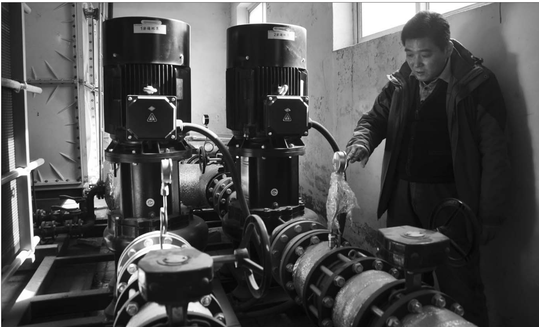
小区新建了换热站,供暖质量好转。本报记者 李岩松 摄
