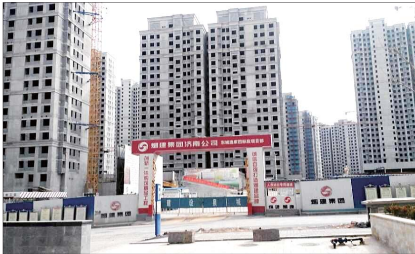
正在施工的东城逸家片区有望实现分质供水。 本报记者 蒋龙龙 实习生 王伟 摄
