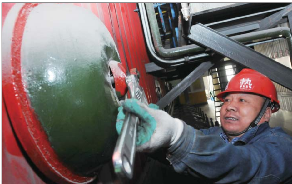
工作人员在用钳子打开手孔(对锅炉进行防潮)。 本报记者 王鸿哲 摄
