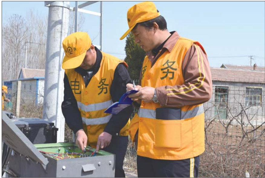
济南电务段工人正在测量设备电压。
