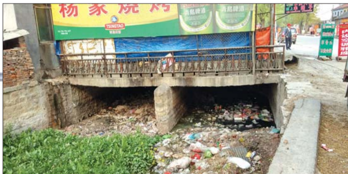
河道里堆着垃圾,烧烤店的下水道出口也对准胜利渠。本报记者 侯峰 摄
