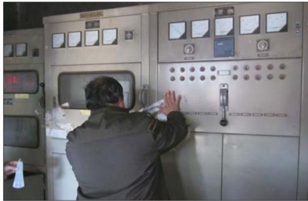
执法人员给该砖厂电力设备上贴上封条。
