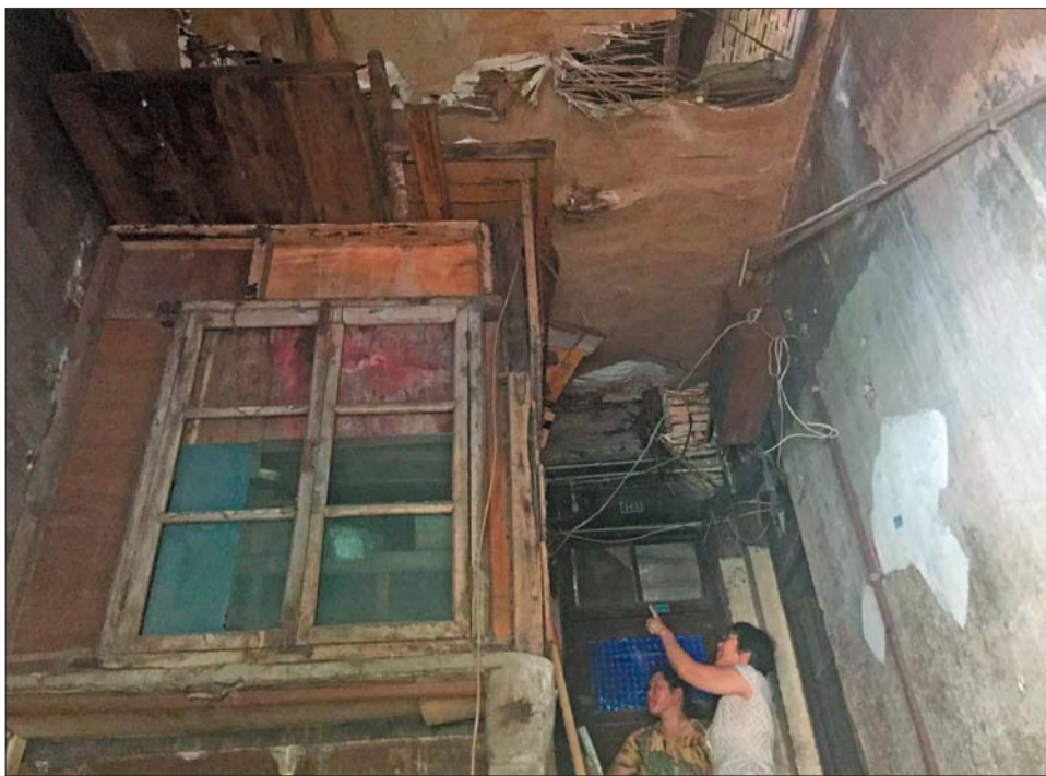
危楼的楼顶已经烂了好几个大洞,漏水严重。
