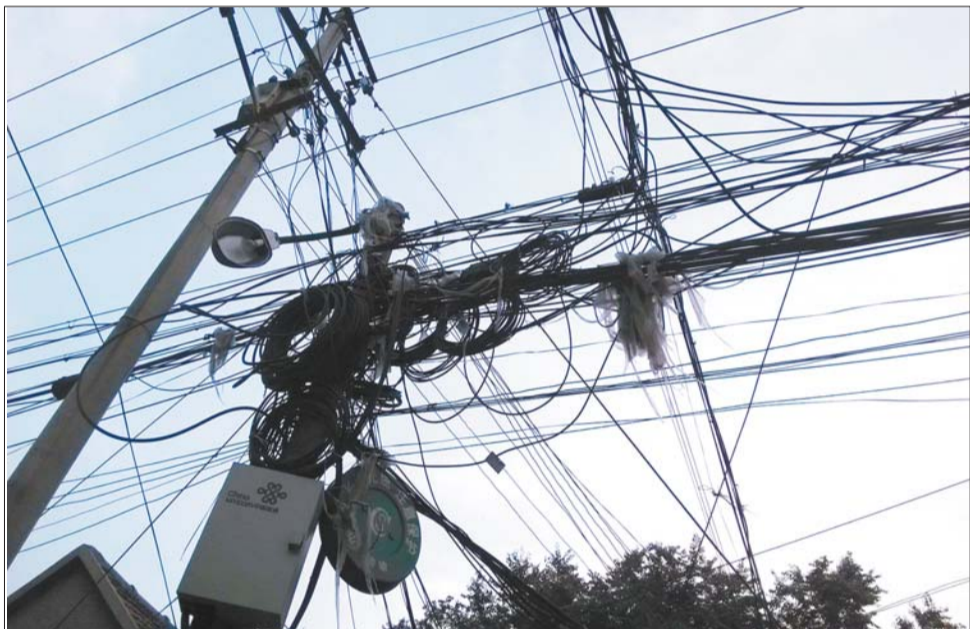
豆腐店村路边的电线杆上线缆乱如麻,一圈圈的电线上还缠绕着不少塑料布。
