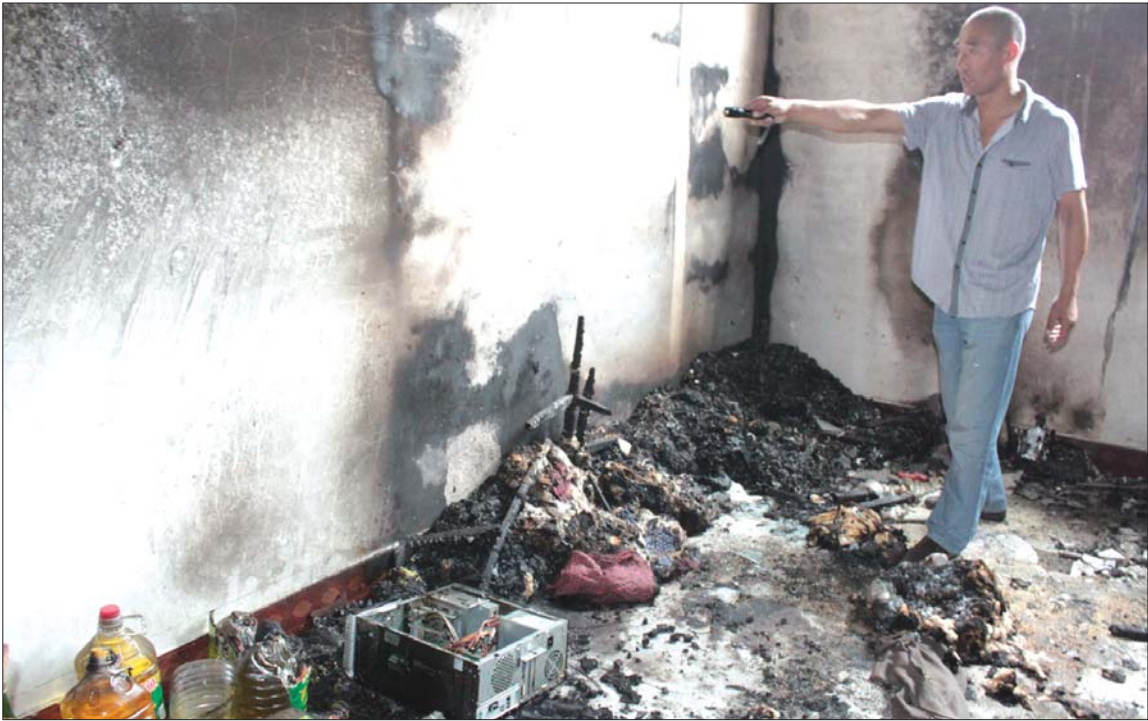
张先生家中被烧得一塌糊涂。本报记者岳茵茵摄
