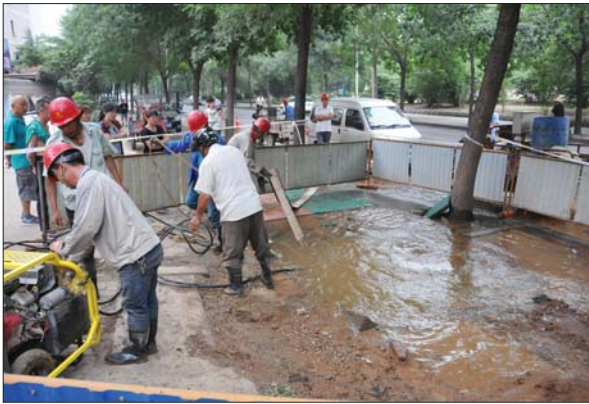
工作人员在现场抢修破裂的自来水管。 本报记者 王鸿哲 摄
