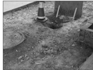
施工影响了电话线路。
