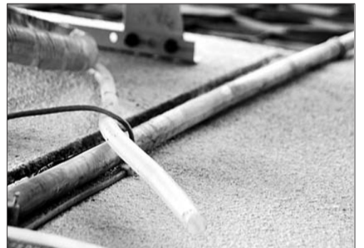
居民家安装的空调管道悬在半空。本报记者 张晓科 摄
