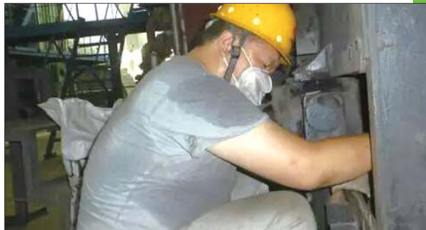
在高温蒸汽锅炉车间,工人的衣服都湿透了。
