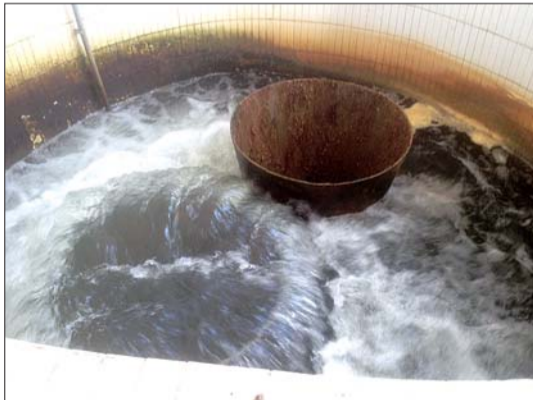
经过水库净化后,配水井里的水清澈见底。
