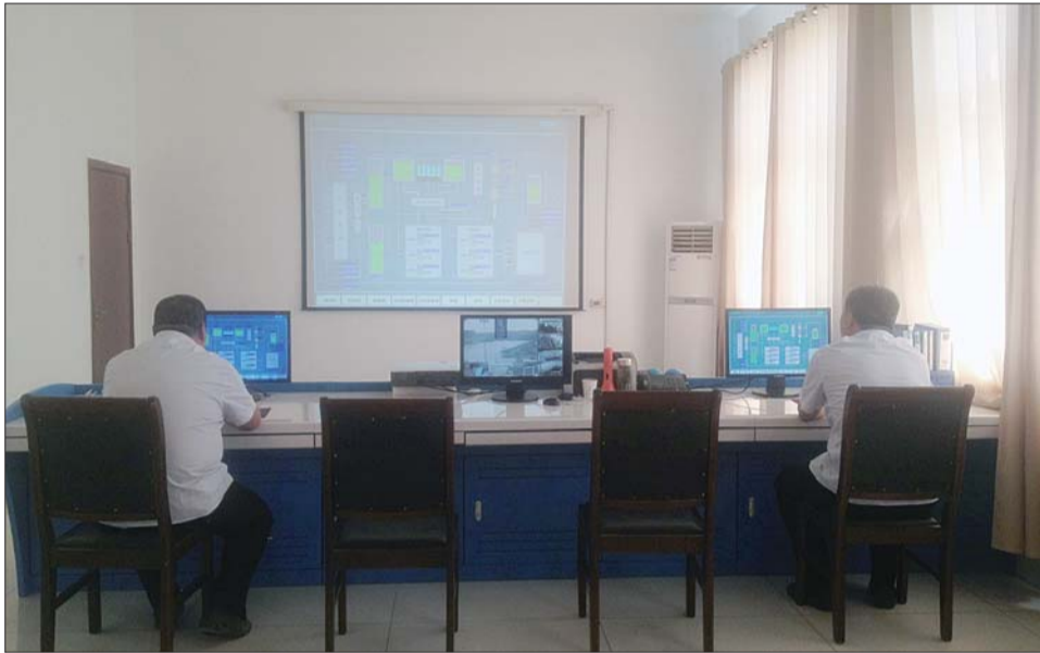
工作人员在中控室操作整个水厂的运行。
