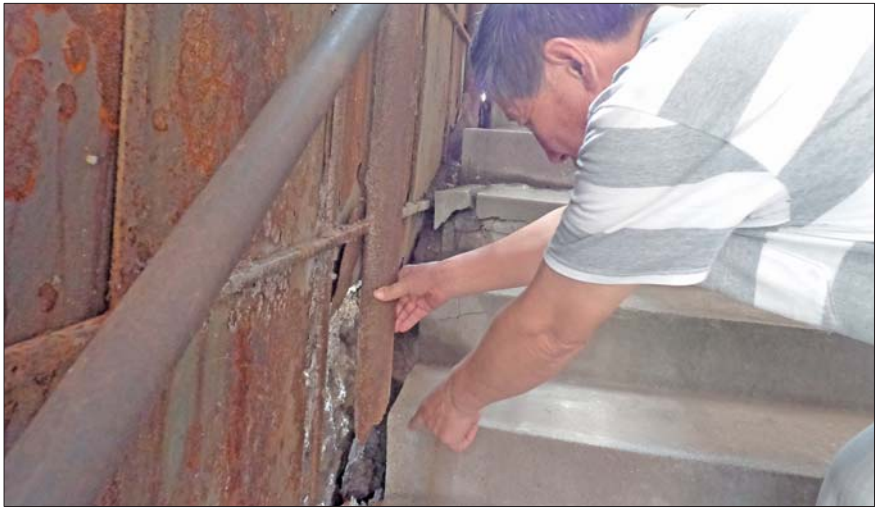
支撑室外楼梯的铁柱底部腐蚀断裂。 本报记者 孟燕 摄
