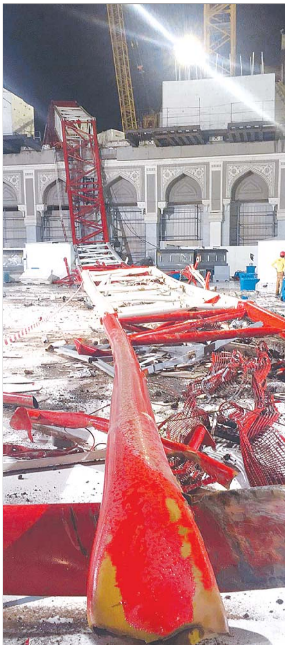
11日,沙特麦加大清真寺塔吊倒塌事故现场。 新华/法新
