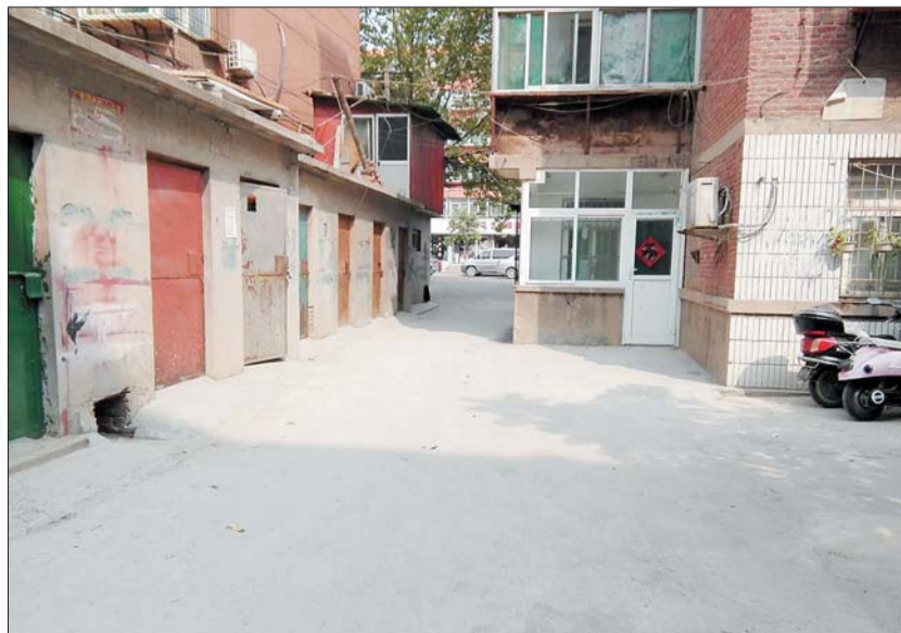
董秀珍所在的小院地面刚刚完成硬化。 本报记者 张九龙 摄
