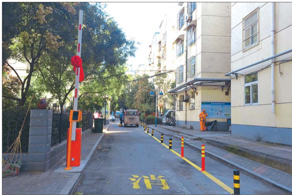
燕山小区安装了8个道闸系统,目前正在做蓝牙调试。本报记者 喻雯 摄
