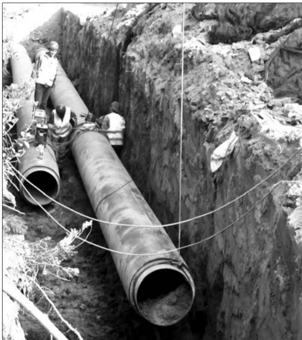
13日,建设东路上,施工人员正忙着铺设供暖管道。 本报记者 邹俊美 摄。
