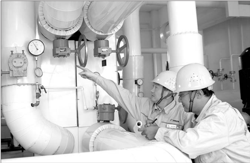
济南热电正对供暖设施的保养情况实时监控。(资料片) 本报记者 蒋龙龙 摄
