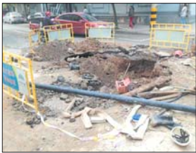
现场水管被压坏后,正在抢修。 本报记者 李阳 摄
