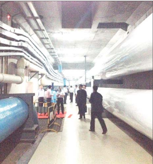
济南二环西路地下综合管廊内景。
