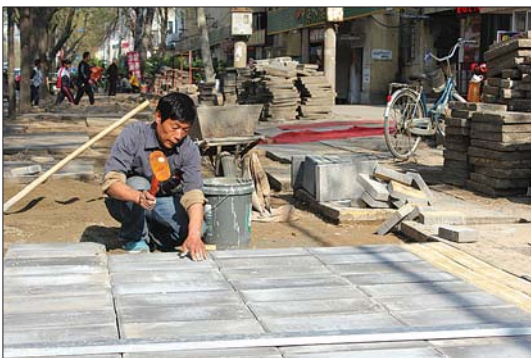
施工人员对老城区人行道进行修整。现在百姓可以明显感受到老街区街道的变化。
