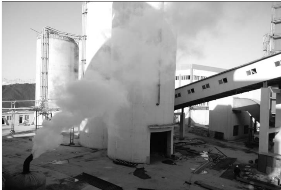
27日凌晨,济南热电北郊热电厂开始点炉,进行厂内供暖设施热调试。 本报记者 蒋龙龙 摄
